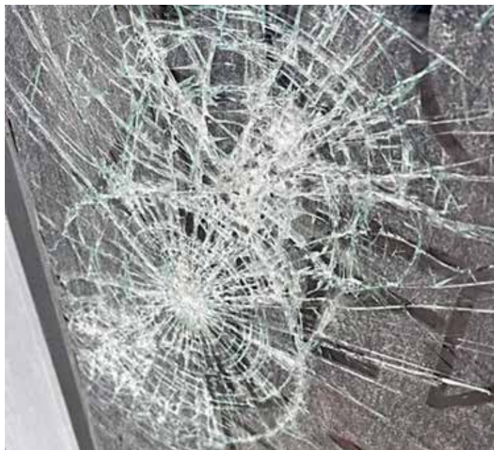
Beschädigte Scheiben und Schmierereien - das ist nicht nur ärgerlich, sondern auch teuer
