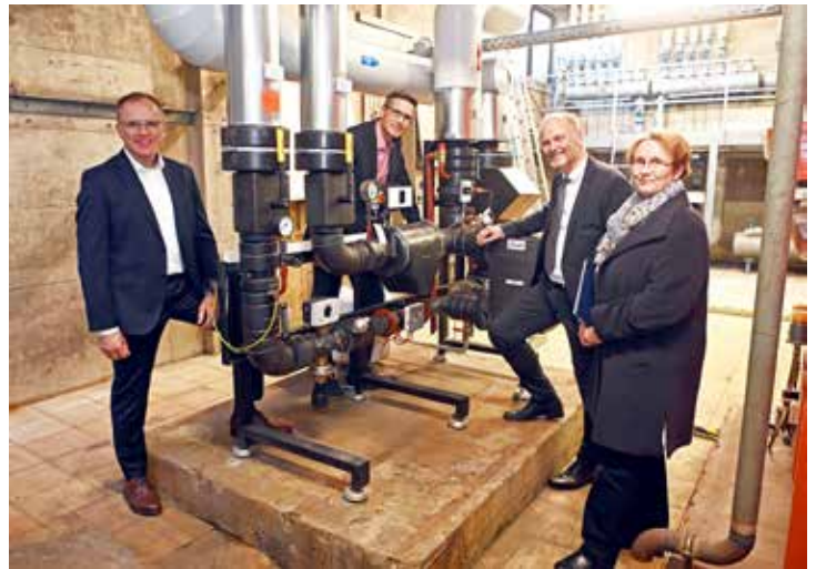
Die Fernwärmeübergabestation im Keller der Schwarzwaldschule Rheinstetten. Bildnachweis: Uli Deck, ARTIS-Photographie
