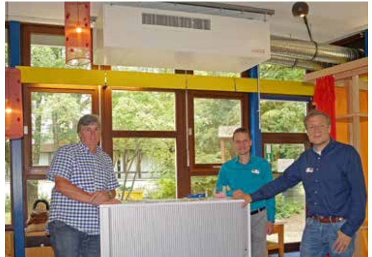
Bürgermeister Michael Heuser, Karl Zobel und Heinz Kluge (v. r.) begutachten eine der neuen raumluftechnischen Anlagen an der Decke eines Gruppenraums im Kindergarten Sonnenblick.
