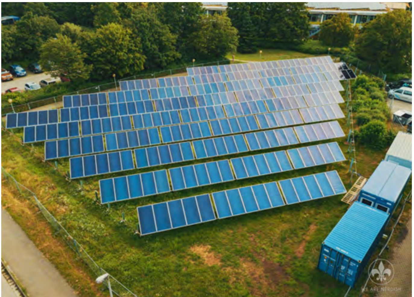
Aufgeständerte Solarthermiekollektoren auf der Grünfläche vor dem Gewerblichen Bildungszentrum (GBZ) in Bruchsal
